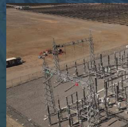
Central Fotovoltaica Las Joyas
