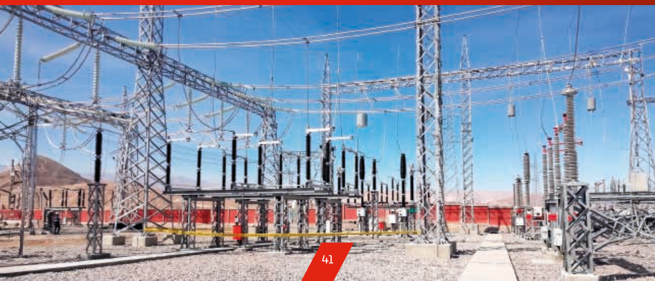
Línea de Transmisión 220 kV Montalvo – Los Héroes
