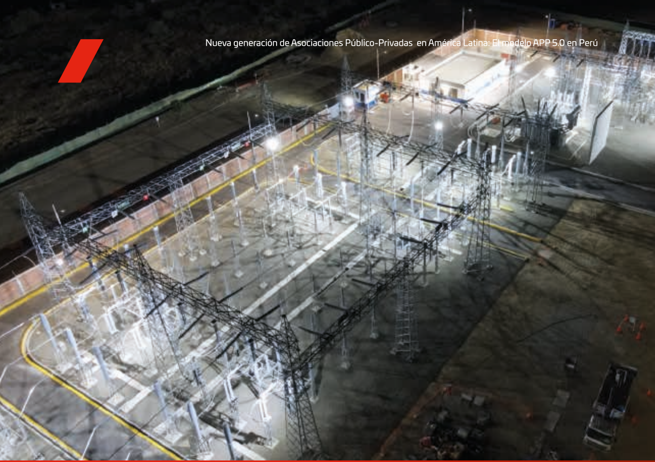
Subestación Valle del Chira
