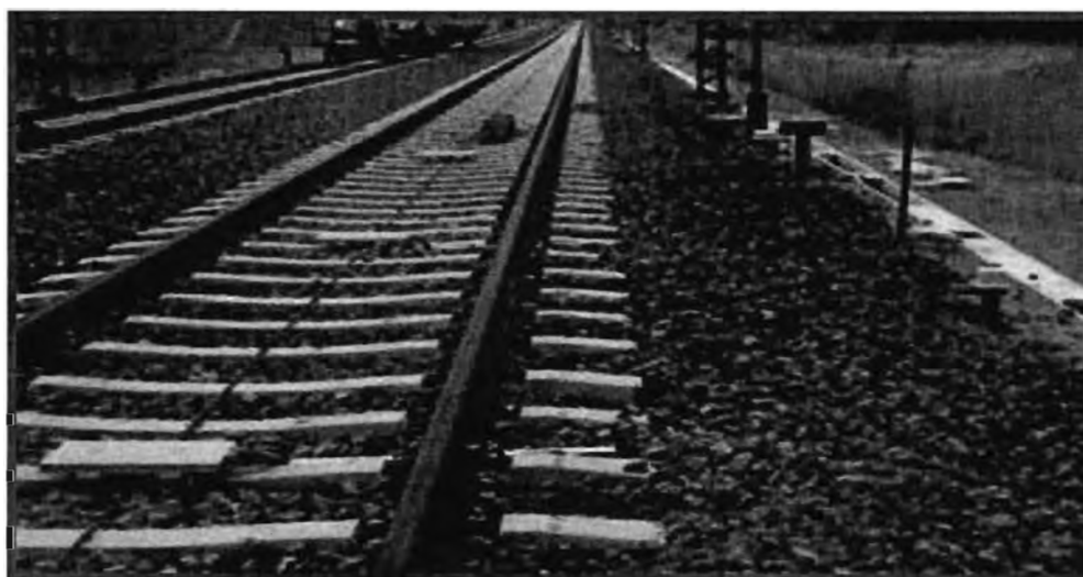
Imagen Referencial de Balizas Conmutables y Fijas
