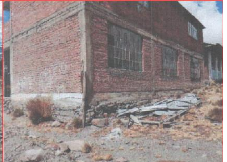
Fotografía N° 03 – construcción q no cumple con la normativa ya q fueron hechos por la APAFA
