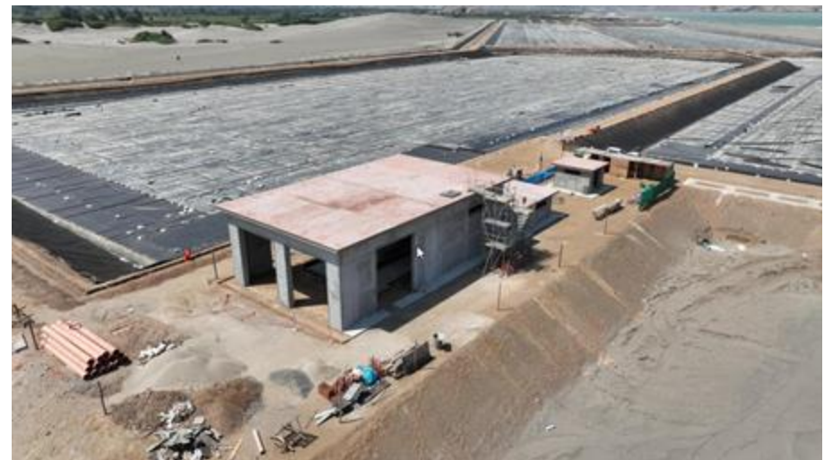
Pretratamiento, Medidor Parshall, G. Electrónico (PTAR)
