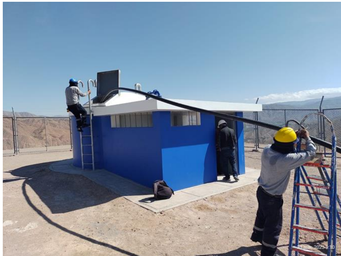
Sistema de Agua
