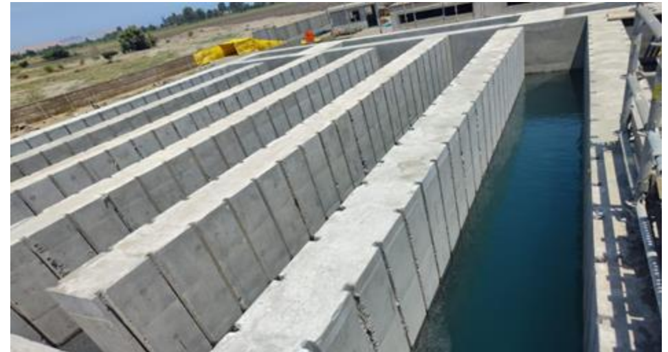
Caja de ingreso, oxidación y filtros (PTAP)
