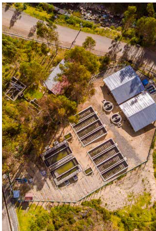
Planta de Tratamiento de Agua en Tlacayan - Pasco.
