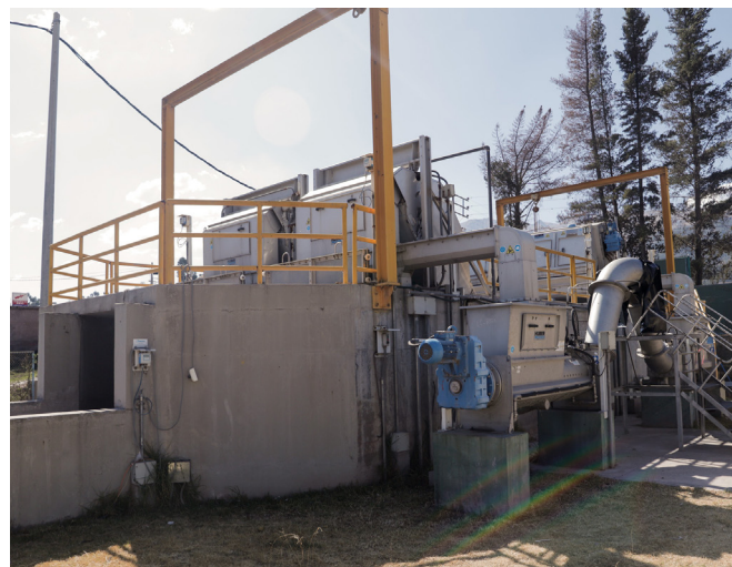
Imagen referencial Planta de tratamiento de agua residual
