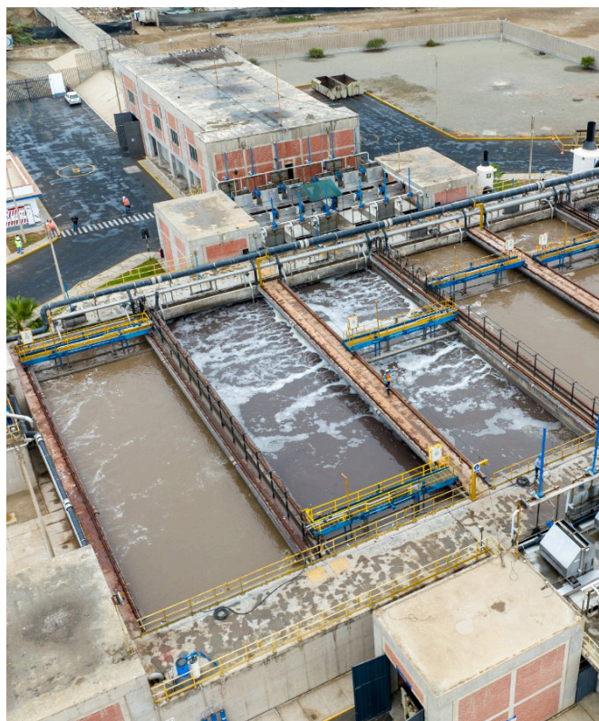
Planta de tratamiento de agua residual, La Chira - Chorrillos, Lima
