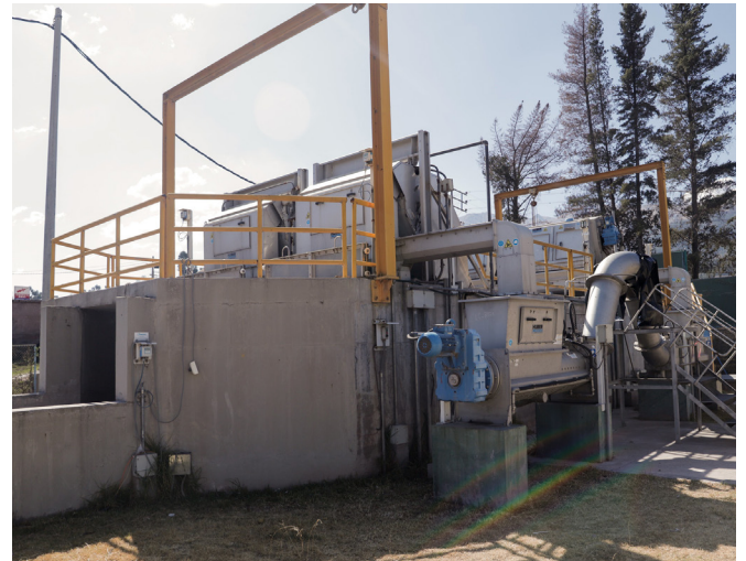
Imagen referencial Planta de tratamiento de agua residual
