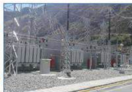
Autotransformadores 500/220/33 kV S.E. Colcabamba
