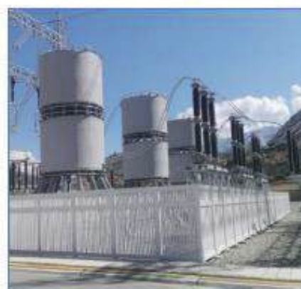
S.E. Colcabamba: reactor serie 220 kV
