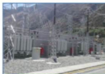
Autotransformadores 500/220/33 kV S.E. Colcabamba
