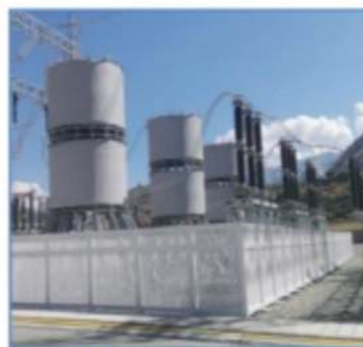
S.E. Colcabamba: reactor serie 220 kV
