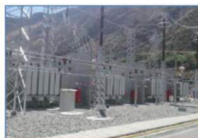
Autotransformadores 500/220/33 kV S.E. Colcabamba
