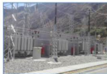
Autotransformadores 500/220/33 kV S.E. Colcabamba
