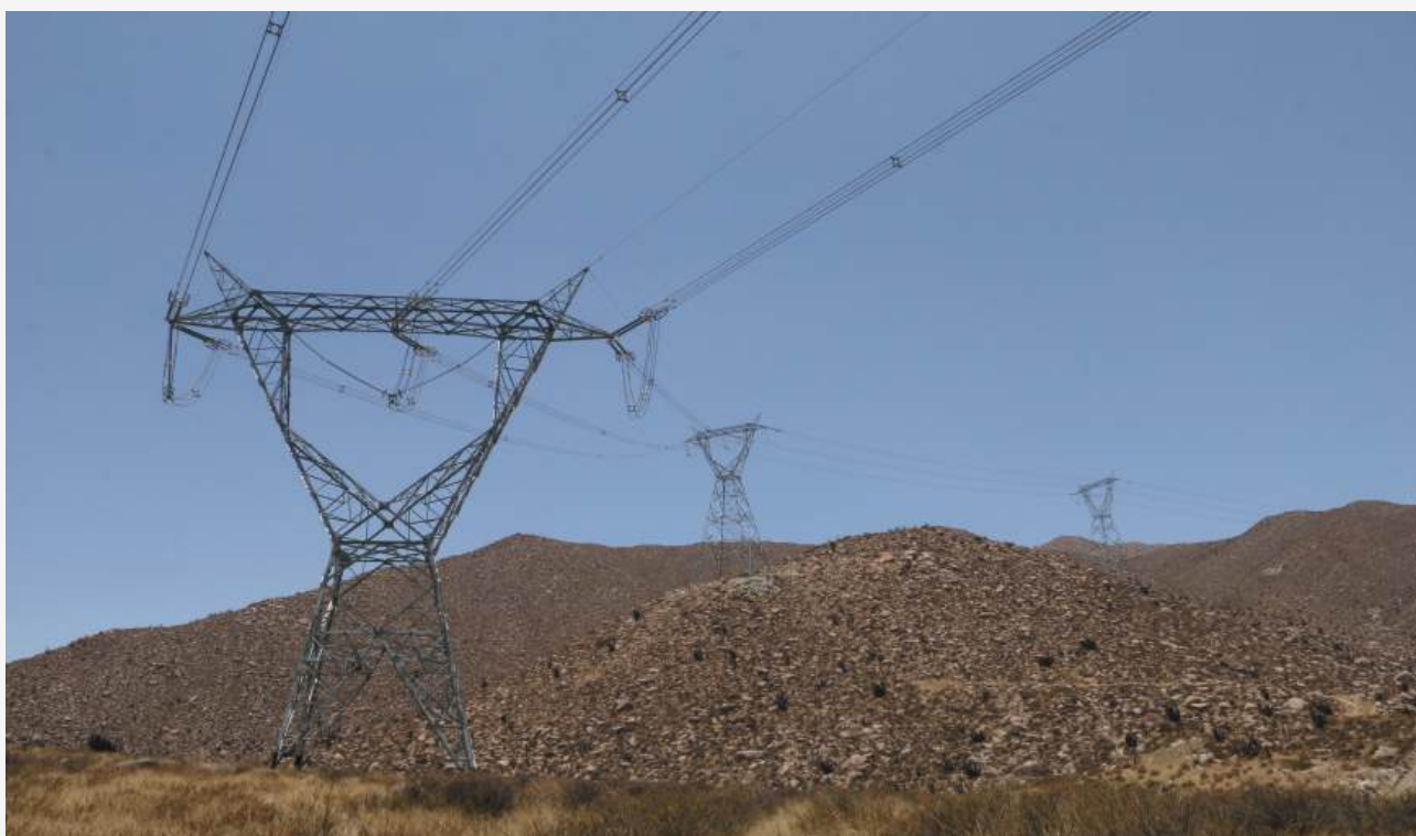
Línea de Transmisión 500 kV Mantaro-Marcona-Socabaya-Montalvo y subestaciones asociadas: caso de estudio de una Asociación Público-Privada en el Perú
