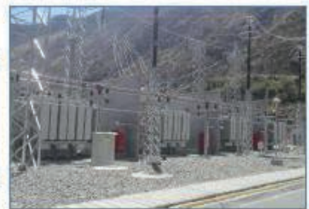
Autotransformadores 500/220/33 kV S.E. Colcabamba
