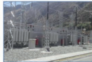
Autotransformadores 500/220/33 kV S.E. Colcabamba
