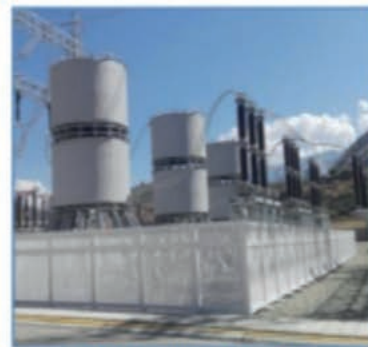
S.E. Colcabamba: reactor serie 220 kV
