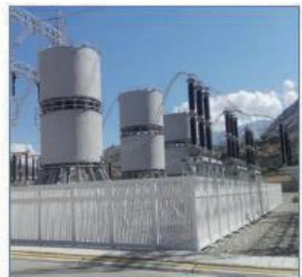
S.E. Colcabamba: reactor serie 220 kV
